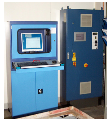
Schaltschrank mit Farb-Touch-Panel und angeschlossenem PC
